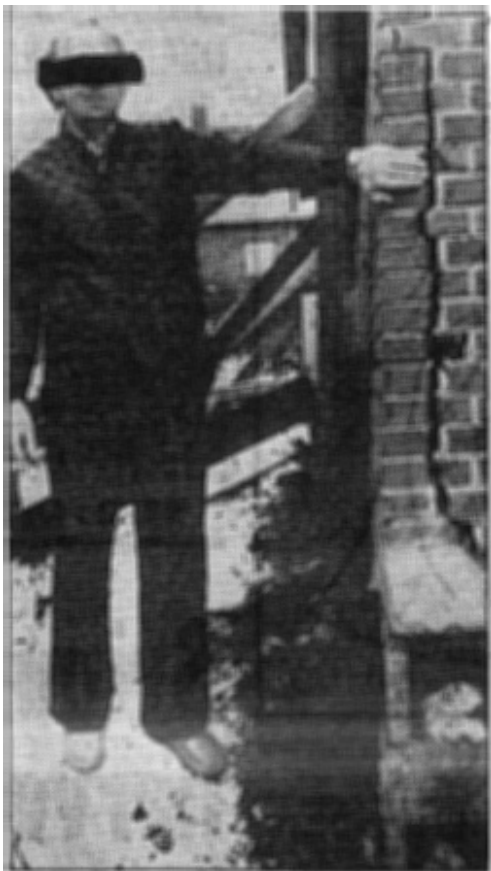
en ved den faldefærdige villa
