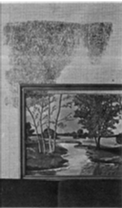
På indvendige vægge kommer der fugtskader, der viser sig, når malerierne tages ned.
