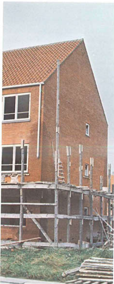
Byggefejl: Manglende udspyrer på nedløbsrør under opførelsen af dette 3-etagers beboelseshus.
